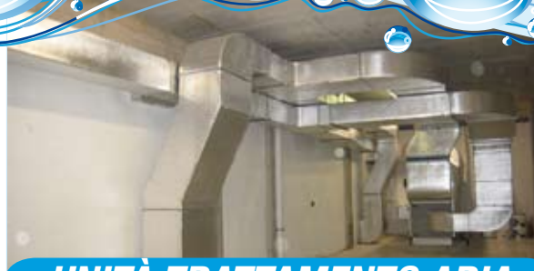
UNITÀ TRATTAMENTO ARIA
